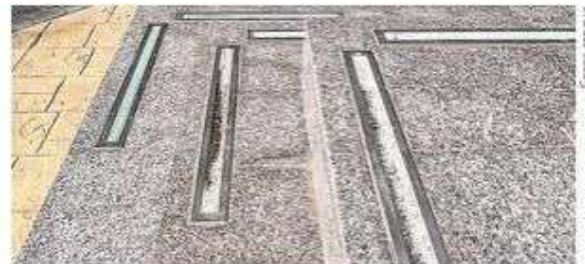
En estas condiciones quedaron las luminarias que hacen resaltar el monumento en Avenida Bulnes.
